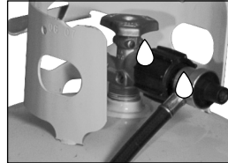
Fuga Regulador y manguera
